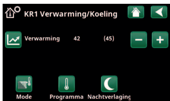
Menu "Installateur/Definieer/Verwarmingskring/Verwarmingskring 1". Het verwarmingskring heeft geen ruimtevoeler. Het setpoint (vertrektemperatuur 45 °C) staat tussen haakjes, de huidige vertrektemperatuur 42 °C staat links van het setpoint.
