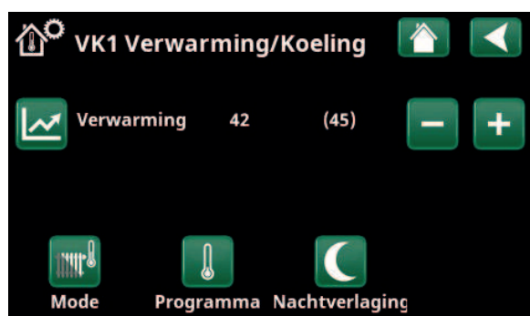
Menu "Installateur/Definieer/Verwarmingskring/Verwarmingskring 1". Het verwarmingskring heeft geen ruimtevoeler. Het setpoint (vertrektemperatuur 45 °C) staat tussen haakjes, de huidige vertrektemperatuur 42 °C staat links van het setpoint.
